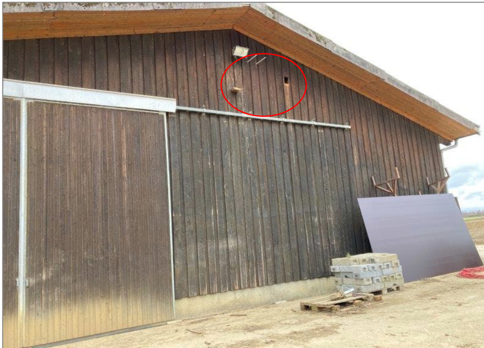
Abb. 12: Östlicher Teil SO 2: Westliche Fassade Bestandsgebäude mit Einflugloch und Ansitz für Vögel (Foto: HPC AG, 07.02.2024)
